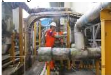
Gambar 4. Inspeksi pelindung panas pipa
